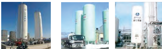
Рисунок 1— Резервуары для хранения СПГ
