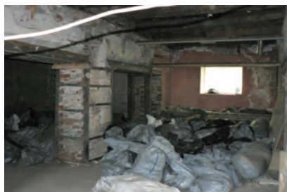
Рис. 2. Общий вид аварийных внутренних стен
