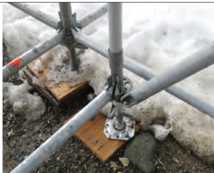
Фотография 5 – Общий вид и конструктивное решение опорных элементов стоек. Отсутствие стационарных фундаментов для временных спортивных трибун
