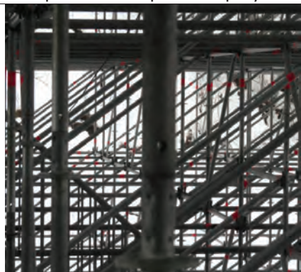
Фотография 7 – Отсутствие болтов в соединительных узлах стоек
