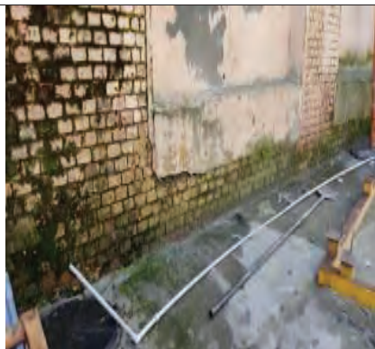
Фотография 4 – Намокание кирпича, грибковые образования и появление мха на наружной несущей стене здания
