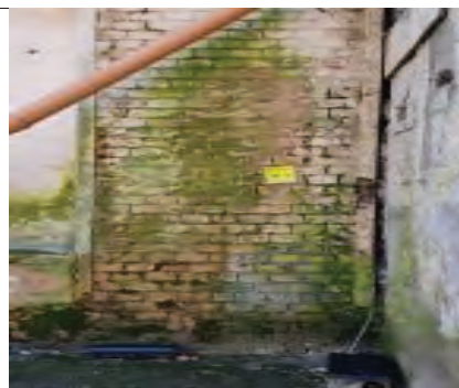
Фотография 1 – Намокание кирпича, грибковые образования и появление мха на наружной несущей стене здания
