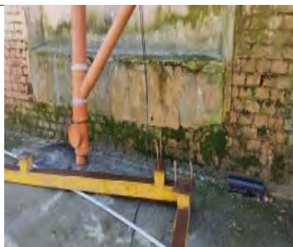
Фотография 2 – Намокание кирпича, грибковые образования и появление мха на наружной несущей стене здания
