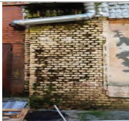
Фотография 3 – Намокание кирпича, грибковые образования и появление мха на наружной несущей стене здания
