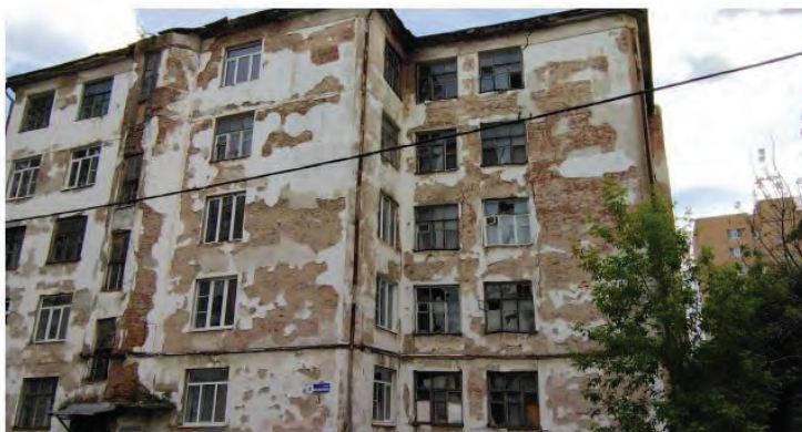
Рисунок 1 – Кирпичное здание, поврежденное от затопления подвала, сильного увлажнения грунтов и подмыва основания фундаментов и угрожающее обрушением
