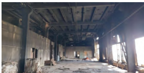
Рисунок 1 – Повреждение железобетонных конструкций после пожара
