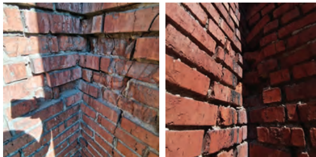
Рисунок 1 – Дефект №1. Выкрашивание раствора швов, выпадение кирпичей из кладки
