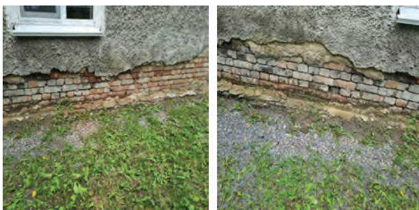
Рисунок 4 – Дефект №4. Замачивание кирпичной кладки и раствора швов кирпичной кладки, расслоение кирпича.
