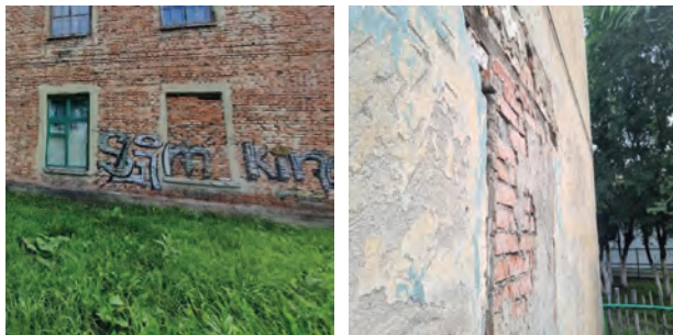
Рисунок 3 – Дефект № . Отсутствует перевязка кирпичной кладки в проемах.
