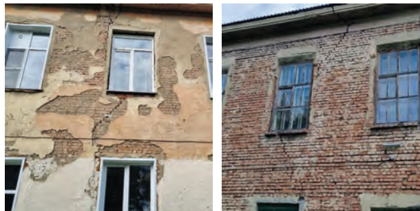
Рисунок 2 – Дефект №2. Вертикальные трещины кирпичной кладки
