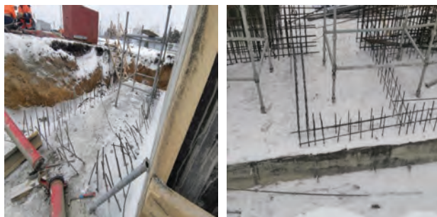
Рисунок 2 – Дефект №2. Нарушение проектного положения стержней арматурных выпусков (отклонения от вертикали и горизонтали)
