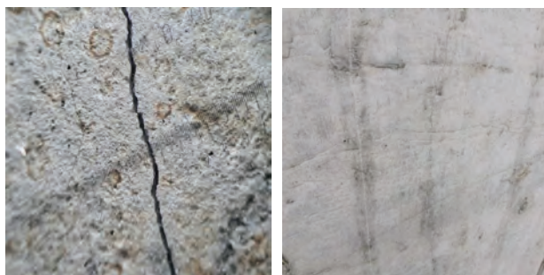
Рисунок 3 – Дефект №3. Раковины на поверхности бетона, усадочные трещины с шириной раскрытия до 0,3 мм
