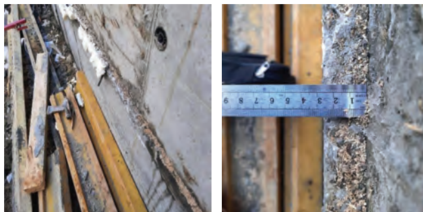
Рисунок 4 – Дефект №4. Перепады на поверхности стен, не запланированные проектом
