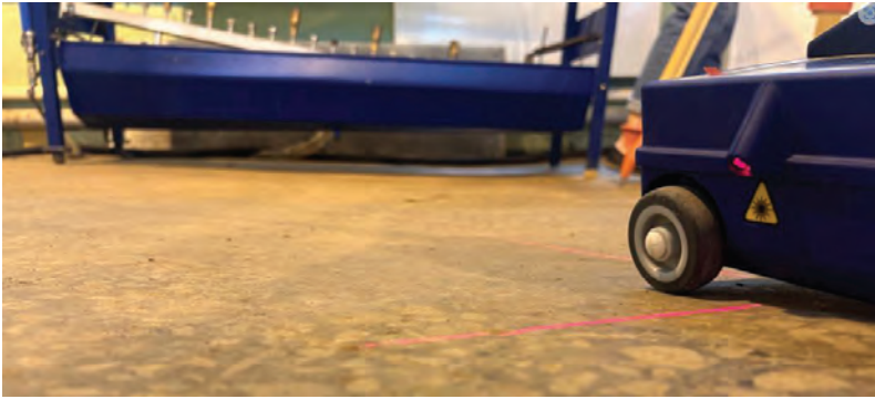
Рисунок 2. Плита с дефектом, на которой по оси X имеется значительная просадка
