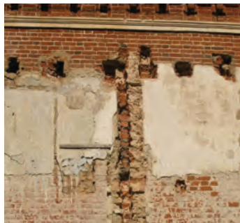
Рисунок 2 – Следы разрушения кирпичной кладки от ранее существующей пристройки
