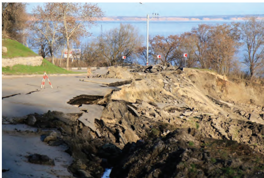
Рисунок 1. Сход оползня в Ульяновской области
