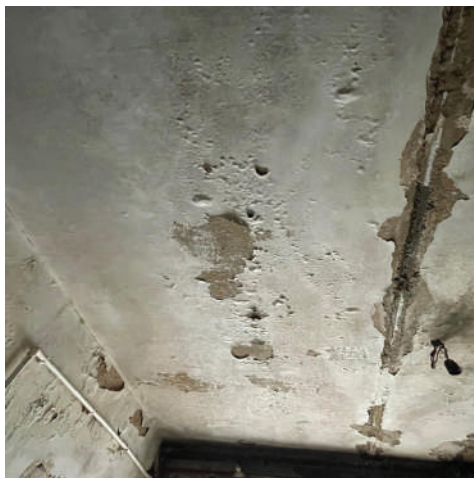
Фотография 3 – Дефекты ж / б плиты перекрытия из - а высокой влажности
