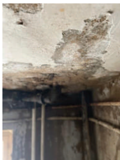
Фотография 2 – Дефекты ж / б плиты перекрытия из - а высокой влажности
