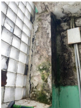
Фотография 1 – Поврежденные конструкции плесенью
