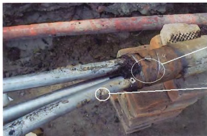
Рис. 1. Коррозия внешней оболочки и точечная сквозная коррозия свинца
