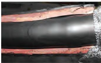
Рис. 3. Плохо смонтированная усадочная муфта
