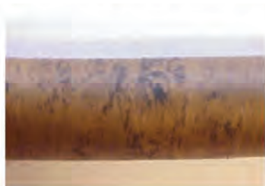
Рис.2. Следы частичного разряда в промежуточных слоях бумаги
