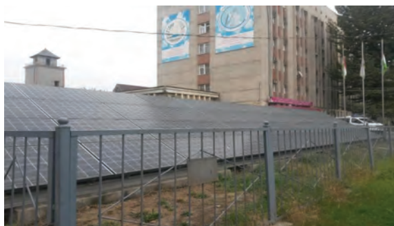
Рис. 2 – Солнечные батареи, установленные в родильном доме №1 г. Душанбе
