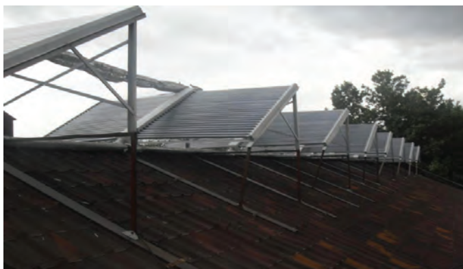
Рис.3 – Вакуумные солнечные коллекторы спортивно оздоровительного комплекса TojVarz в г.Душанбе
