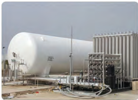
Рисунок 4 – Станция регазификации СПГ объемом 600 м 3
