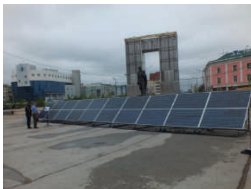
Рис.5 Солнечная электростанция в поселке Батагай
