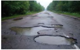
Рис.2. Автомобильная дорога с дефектами и повреждениями
