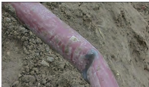
Рисунок 1. Прорыв газового магистрального трубопровода
