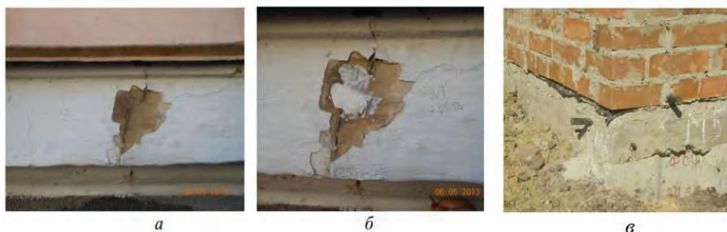
Рисунок 1 – Существующая трещина (а) в несущей стене объекта геомониторинга и гипсовый маяк (б) на ней с указанием даты его установки, в) Поверхностные (стеновые) марки на цоколя в несущих стенах объекта геомониторинга для фиксации их осадок
