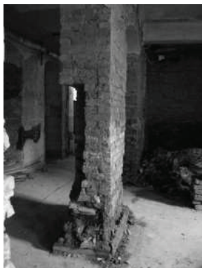
Рисунок 1 – Разрушение кирпичной кладки простенков
