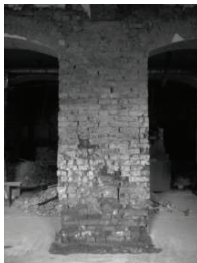
Рисунок 2 – Трещины и вздутия
